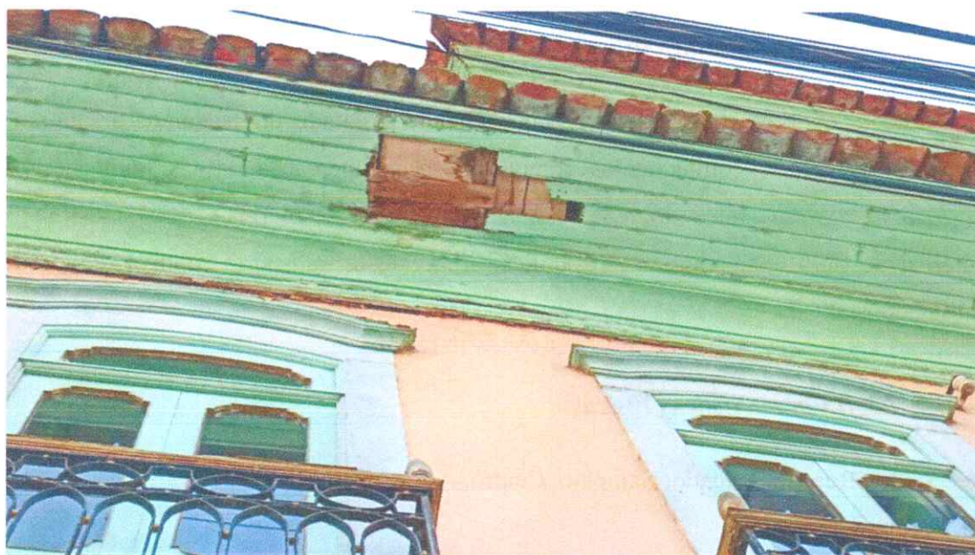
Figura 8: Beiral da fachada com falta de madeiramento de fechamento.
