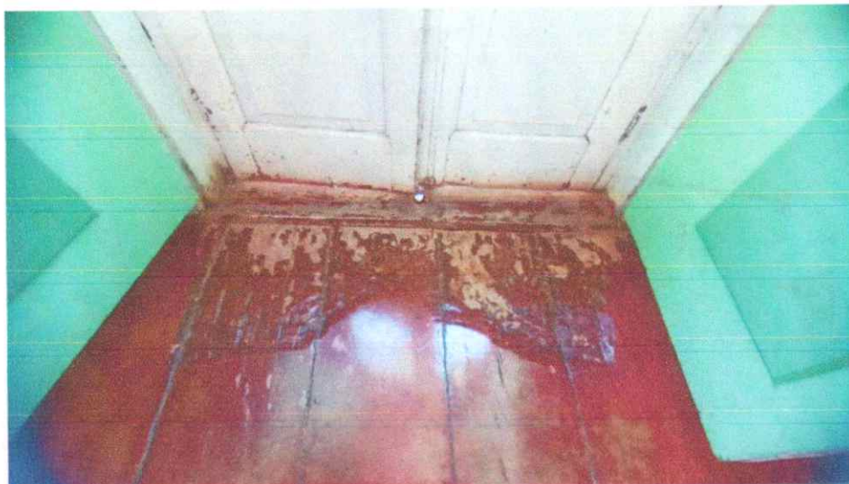
Figura 41: Detalhe do desgaste do piso de madeira devido a abertura da porta
