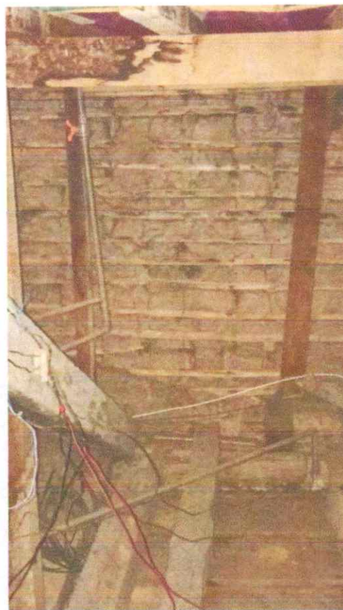
Figura 48: Detalhes das paredes originais de taipa
